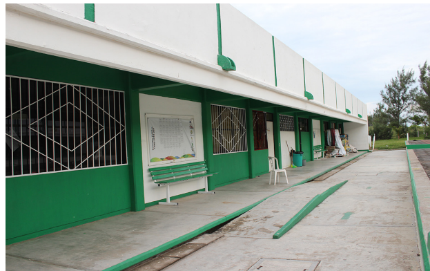
Aulas y laboratorios con protecciones
